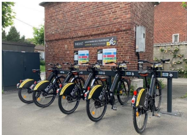
Figure 8 : station pour vélos électriques – Givenchy-en-Gohelle
